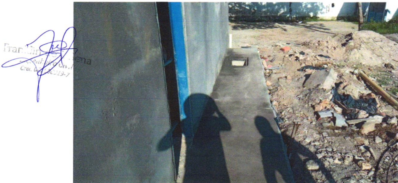
Foto 28 - EXECUÇÃO DE PASSEIO (CALÇADA) OU PISO DE CONCRETO COM CONCRETO MOLDADO IN LOCO, FEITO EM OBRA, ACABAMENTO CONVENCIONAL, ESPESSURA 8 CM, ARMADO. AF_07/2016
