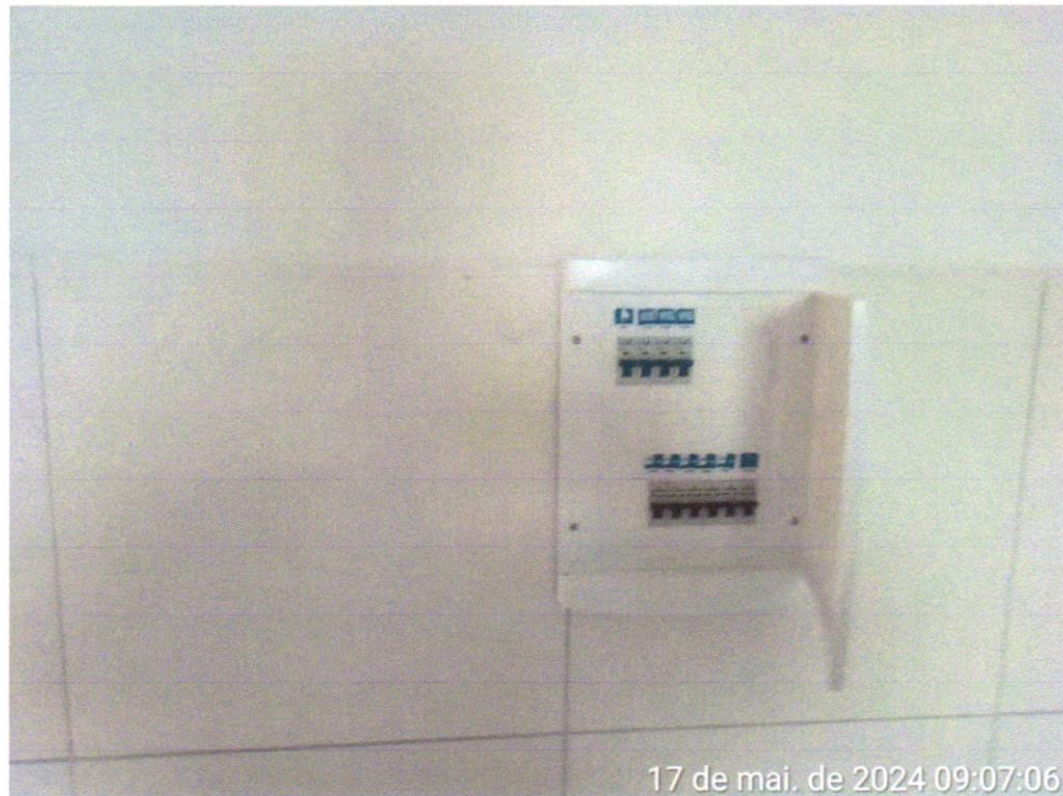
Foto 29 – QUADRO COM DISJUNTORES
